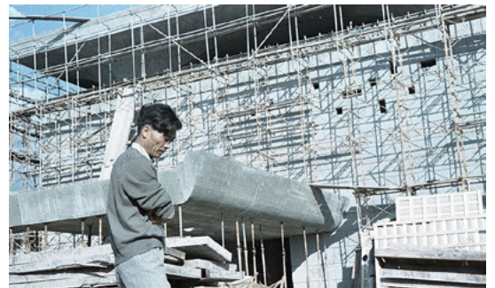
施工写真(智積院会館) 資料情報: [智積院会館](部分), Ar MIXED 2017/2/S5-02/087, “増田友也建築設計関係資料, 1930-1984 (主年代1950-1981).”
