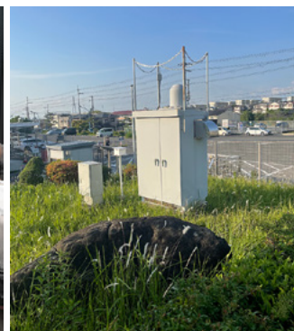
施設内に多数設置されているモニタリングポスト
