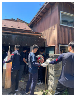
被災家屋の片付けを行う様子
